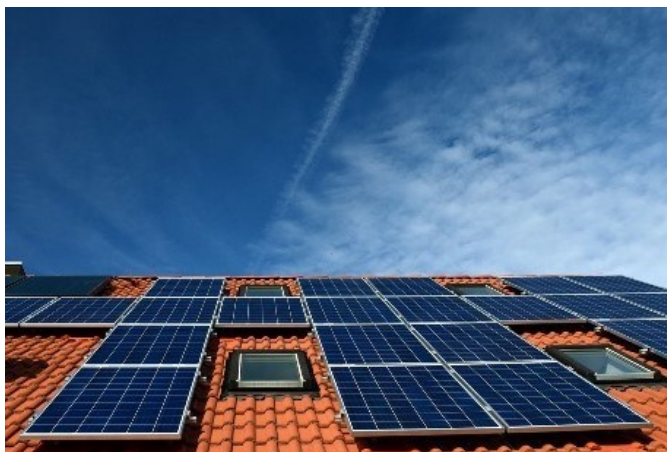
Photovoltaikanlagen werden immer öfter zur Eigenstromversorgung genutzt (Bildquelle: Pixabay_ulleo)
